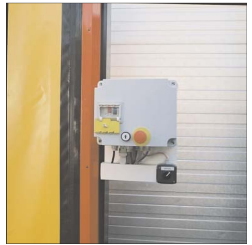
Bild på styrskåp med nödstop
