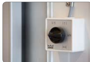
Manöverpanel till automatisk dörröppnare.
